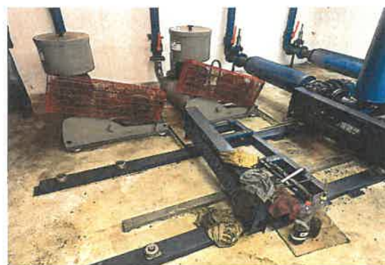
Biologické čištění – dmychárna
