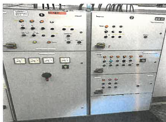
Velín ČOV – řídicí rozvaděč
